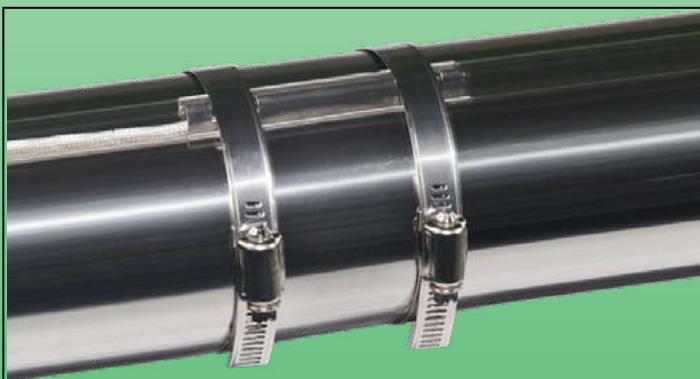
Ejemplo del modelo de sensor de temperatura después de la instalación.
